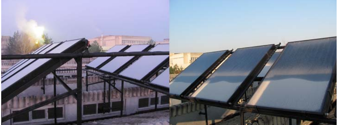
Şekil 4.52. Güneş kolektörleri üzerindeki buzlanma ve buzların çözülmesi (Deney-7)
