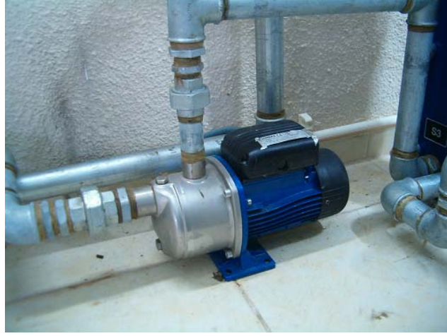
Şekil 3.29. Soğutma kulesi pompası
