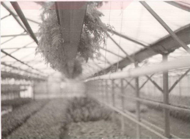
Şekil 4.17. Yerden belli bir yükseklikteki yan borular (VoliaYaşıl Süs Bitkileri İşletmesi).
