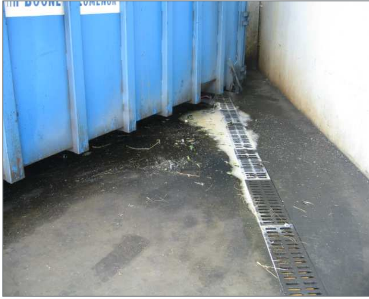
Şekil 4.2. Kimyasal içeren konteynır sızdırmazlık çalışması öncesi durumu
