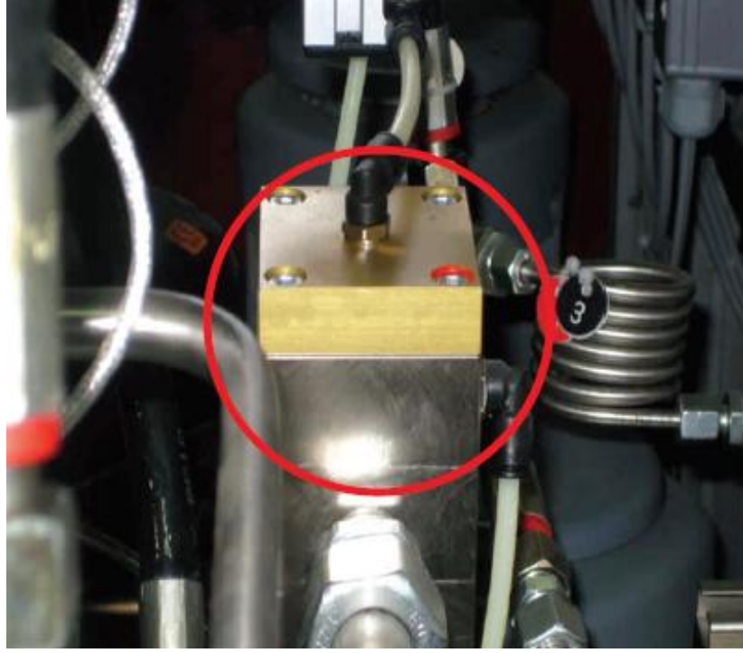
Şekil 3.2. Yüksek basınç pompası
