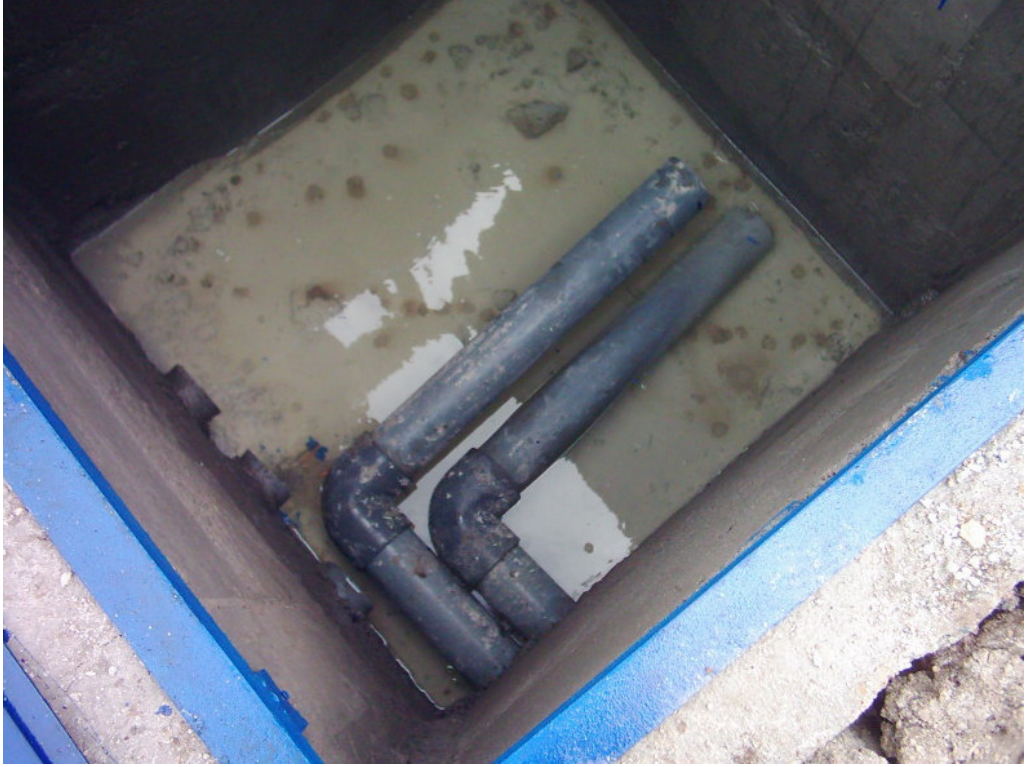
Fotoğraf 5. DAYS sistemi, çıkış atıksuyu toplama haznesi içerisindeki dirsek borularla hareketlendirilmiş boruların görünümü
