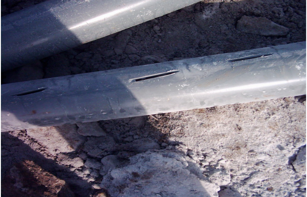
Fotoğraf 6. DAYS sistemi havuz tabanlarına boydan boya döşenen delikli boruların görünümü
