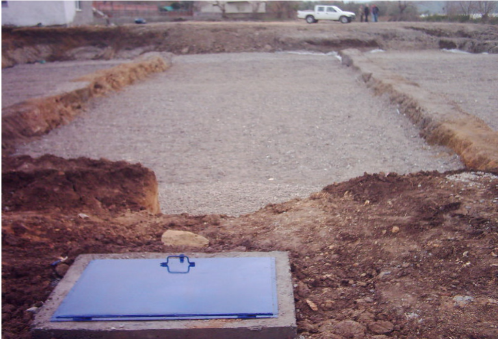
Fotoğraf 2. DAYS sistemi giriş atıksuyu toplama haznesinin görünümü
