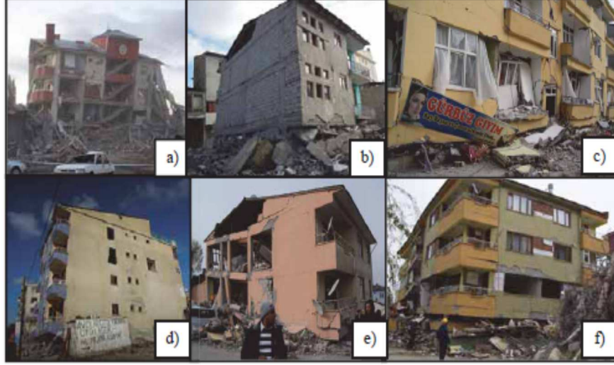
Şekil 2.24. Yumuşak kat düzensizliğinden dolayı yıkılan binalar (Anonim 2011)
