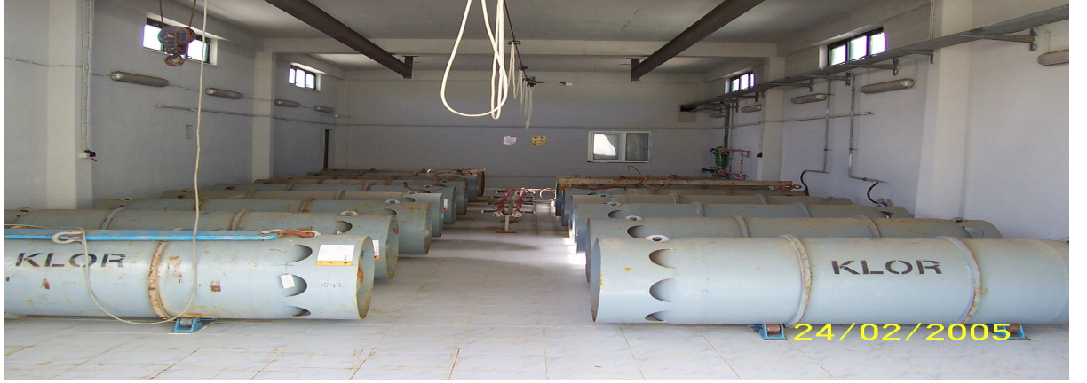
Şekil 3.9 Gaz Klor Tesisi
