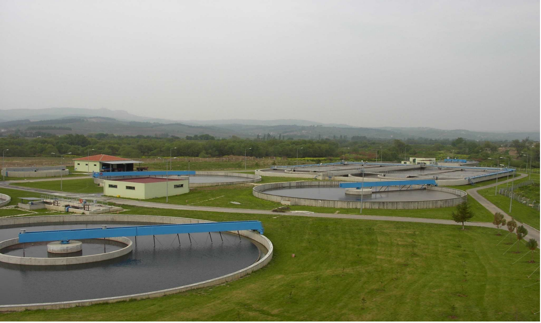
Şekil 3.1 BOSB Su Üretim Tesisi
