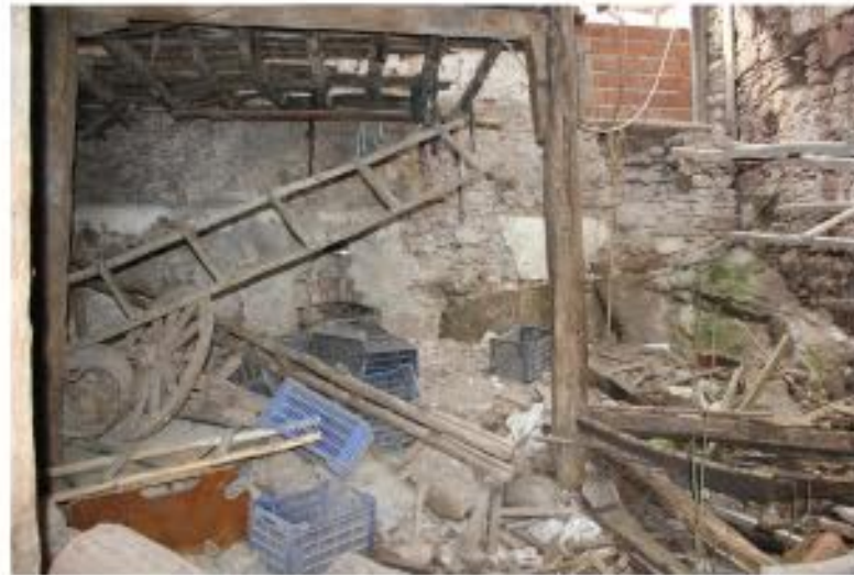
7) Z01 DEPO'UN KISMEN YIKILMIŞ DÖŞEMESİ
