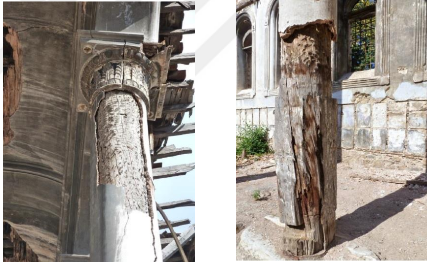
Şekil 5.23. Kayabaşı Holy Apostles Kilisesi'nin sıvasının bir bölümü dökülmüş ahşap dikmeleri (Gülgün Yılmaz Mimarlık Restorasyon arşivine aittir. 2012)
