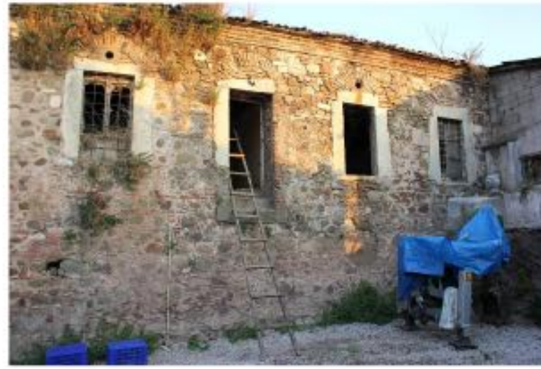
KUZEY CEPHESİ PENCERELERİ VE 1.KATA ULAŞMAK İÇİN SONRADAN BÜYÜTÜLEREK KAPI GİRİŞİ HALİNE GETİRİLEN ORTA PENCERE
