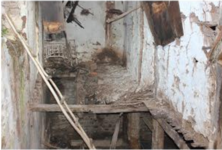
4) 111 ODA – ODANIN KISMEN YIKILMIŞ DÖŞEMESİ
