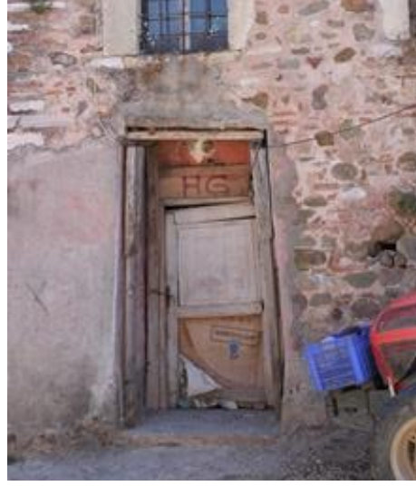
Şekil 5.9. Kilisenin kuzey duvarına sonradan açılmış olan kapı
