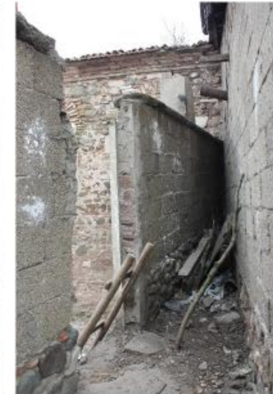
8) YAPI İLE İSTİNAT DUVARI ARASINDAKİ BOŞLUK
