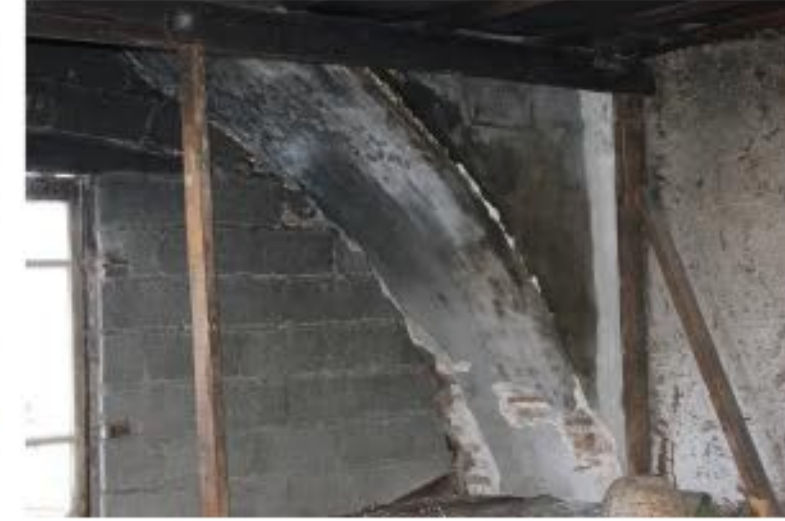
3) DOĞU DUVARI – YIKILAN APSİSİN ÖZGÜN KEMERİNİN TUĞLA ÖRGÜSÜ
