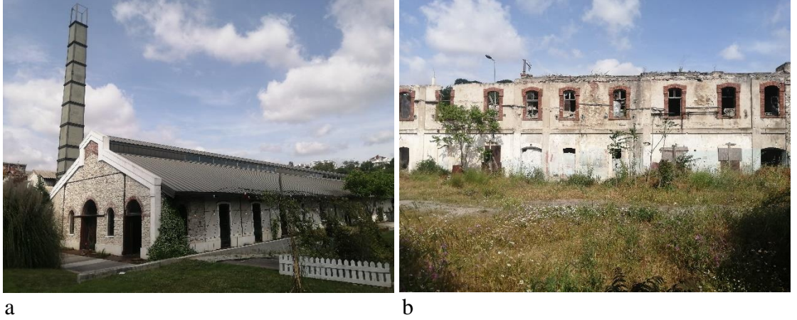
Şekil 4.23. a. Restore edilen kısım dış cephe b. Restore edilmeyen yıkılan kısımlar (Yazar arşivi,2023)
