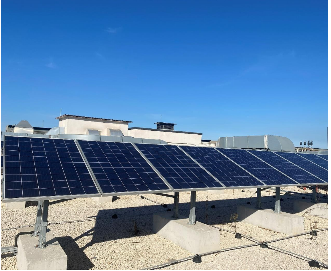
Şekil 4.30. Korunumlu kablo kullanılan PV panel sistemi örneği
