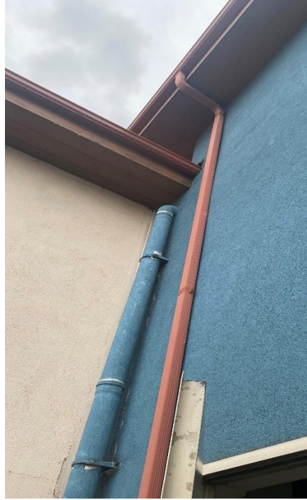
Şekil 4.6. Pik ve PVC yağmur iniş boruları
