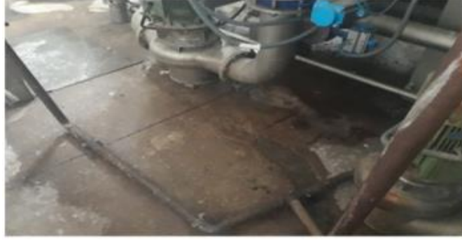
Şekil 3. 9. Kondens dönüş hataları
