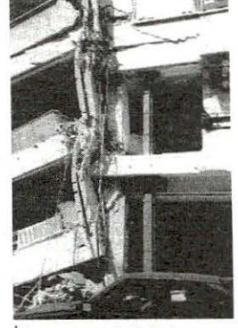
İki yapı arasındaki dilatasyon yetersizliği nedeniyle çarpışması /ADAPAZARI
