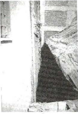
Zeminde sıvılaşma nedeniyle yapının devrilmesi/ADAPAZARI
