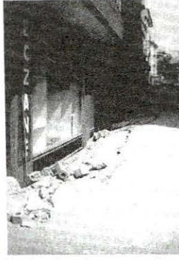
Zemin çökmesi sonucu cadde üzerindeki yapıların hasarı/İZMİT
