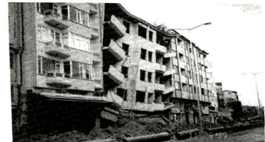
Bitişik nizam yapıların aynı depremden mimari, taşıyıcı sistem ve malzeme kalitesinden dolayı farklı etkilenmeleri/ADAPAZARI
