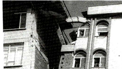
Bitişik nizam yapılarında yatay taşıyıcıların farklı kotlarda olmasının çarpışmaya neden oluşu ve düşey taşıyıcılarda ağır hasar oluşması/ADAPAZARI
