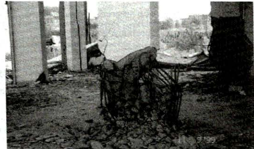
Döşeme ile kolonun birleşme noktasında nervürlü demir kullanımına rağmen sıklaştırılmamış etriye eksikliği sonucu burulma ve betonun dağılması/ADAPAZARI
