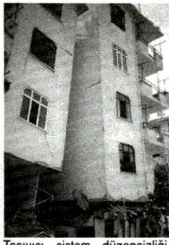
Taşıyıcı sistem düzensizliği nedeniyle ortadaki merdiven kovasının her iki tarafındaki yapıda farklı katların yıkılması /BAHÇECİK
