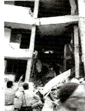
Taşıyıcı sistemdeki rijitlik düzensizliği nedeniyle yapının burulması/ADAPAZARI
