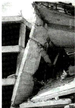
Kötü zemin koşulları nedeniyle çarpışma sonucu taşıyıcı sistemde ağır hasar /ADAPAZARI
