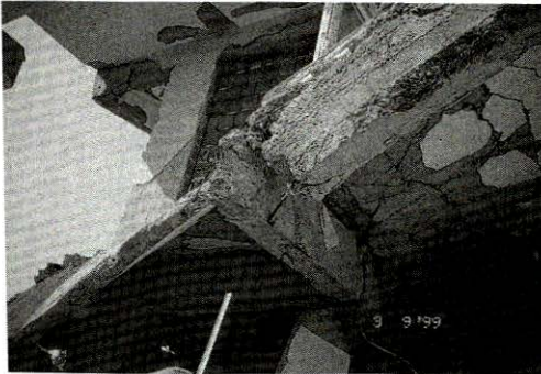
Konsol bağlantılarına kolon ve döşeme deki hasar/ YALOVA
