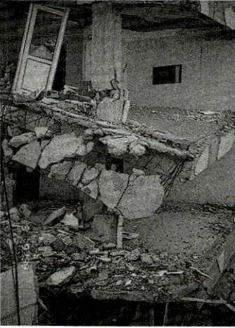
Konsol bağlantılarında kolon ve döşeme deki hasar/ BAHÇECİK
