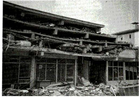
Kolon kırılmaları tüm binanın göçmesi Zayıf kolon, kuvvetli kiriş etkisi / ULAŞLI
