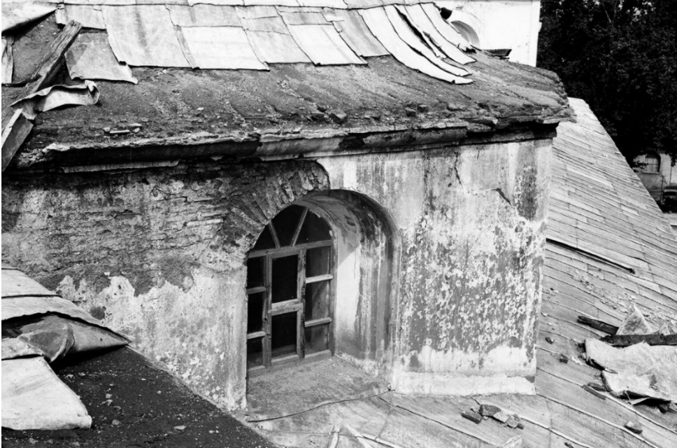
Ulucami'nin kubbe örtülerinde oluşan bozulmaların görünümü (VGM arşivi)
