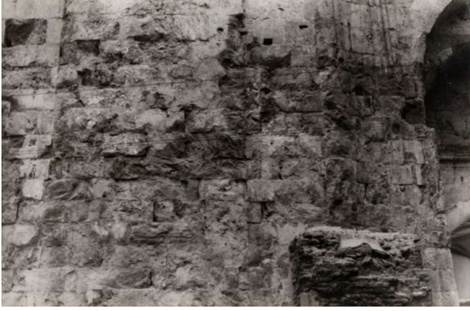
Şekil 3-37. Ulucami'nin batı kapısı yanı, taşlarda oluşan bozulma görünümü ( http://saltresearch.org/ ) [Tasuh3128041]
