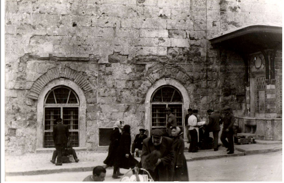
Ulucami'nin batı cephesi, taşlarda oluşan bozulmaların ve henüz yıkılmamış olan çeşmenin görünümü (Kaplanoğlu 2018)
