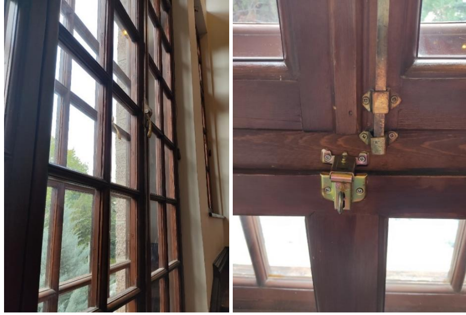
Şekil 4.76. A) II. TBMM Binası Merdiven Penceresi B) II. TBMM Binası Merdiven Penceresi Kilit Sistemi Detayları (Baloğlu 2022)
