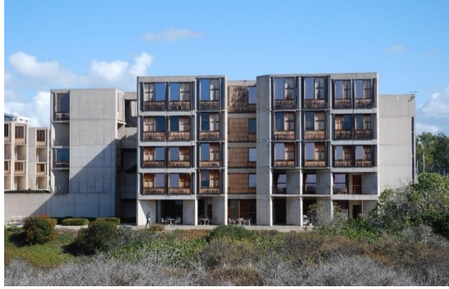
Şekil 2.12. Restorasyon öncesi pencere doğramalarında siyah mantar biyofilmini gösteren batıya bakan ofis kanadının 2013 yılına ait görünümü (Anonim 2017b)
