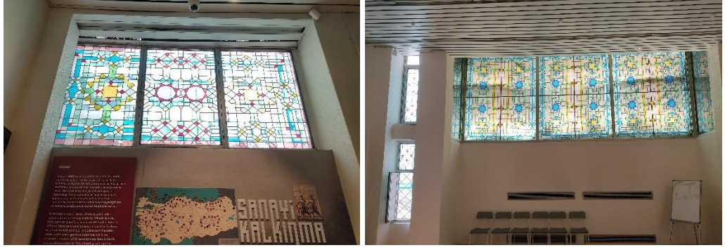
Şekil 4.82. A) B) Vitray uygulaması yapılan niteliksiz pencere örnekleri (Baloğlu 2022)
