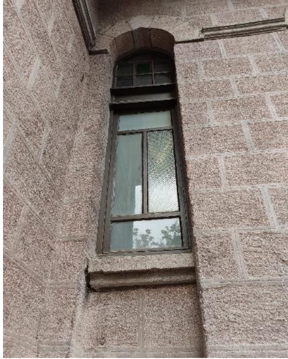
Şekil 4.67. Bozulmuş Sivri Kemer Pencere (Baloğlu 2022)
