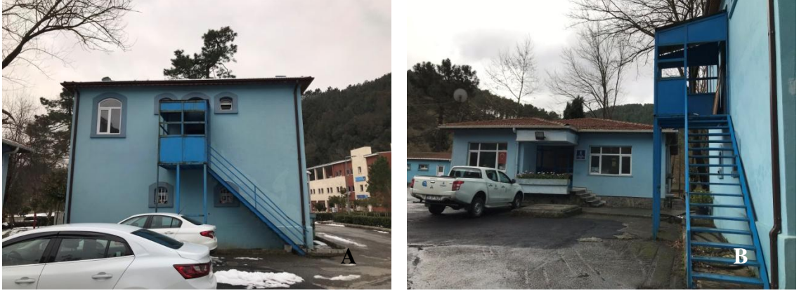
Şekil 4.16. A) Eski idari bina doğu cephesi ( Filiz Öztürk, 2022) B) Eski idari bina merdiven detay ( Filiz Öztürk, 2020)
