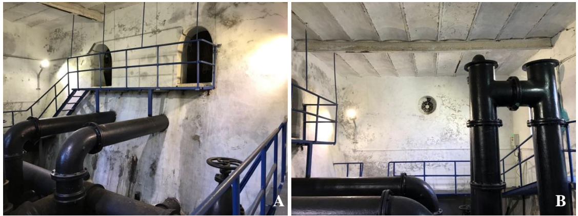
Şekil 4.37.A) Manevra odasından sarnıca doğru açıklıklar ( Filiz Öztürk, 2022) B) Manevra odası ( Filiz Öztürk, 2022)
