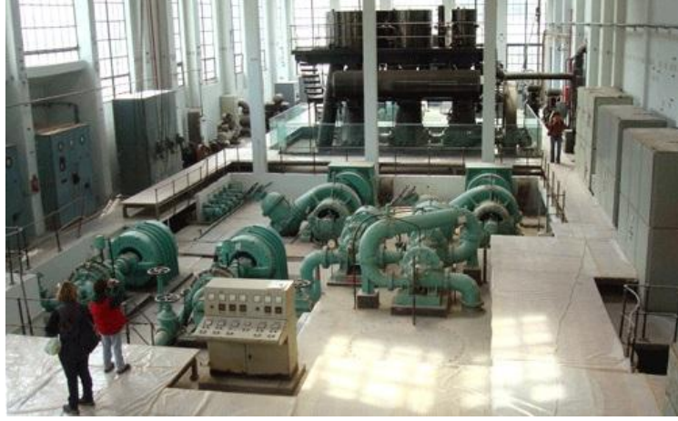
Şekil 2.20. Pompa binası iç kısım (Tanyeli ve ark. 2012b)
