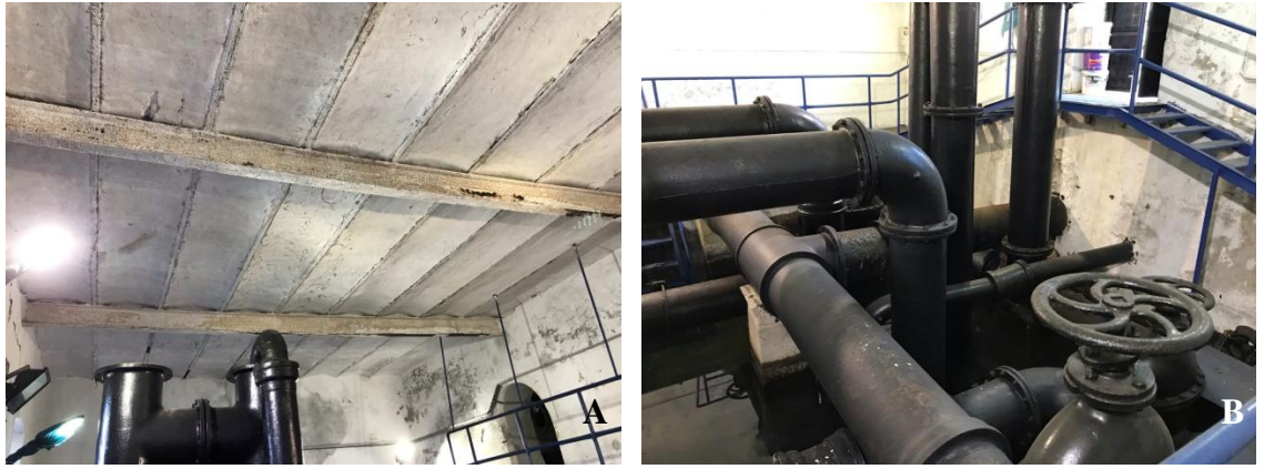
Şekil 4.36. A) Manevra odası çatı detayı ( Filiz Öztürk, 2022) B) Manevra odası tesisat ( Filiz Öztürk, 2022)
