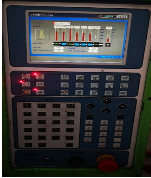
Şekil 3.6. Enjeksiyon kontrol ünitesi
