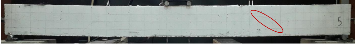
Şekil 4.50. En kesiti 108x200 dengeli donatı oranında donatılı deney numunesinde oluşan ilk çatlak
