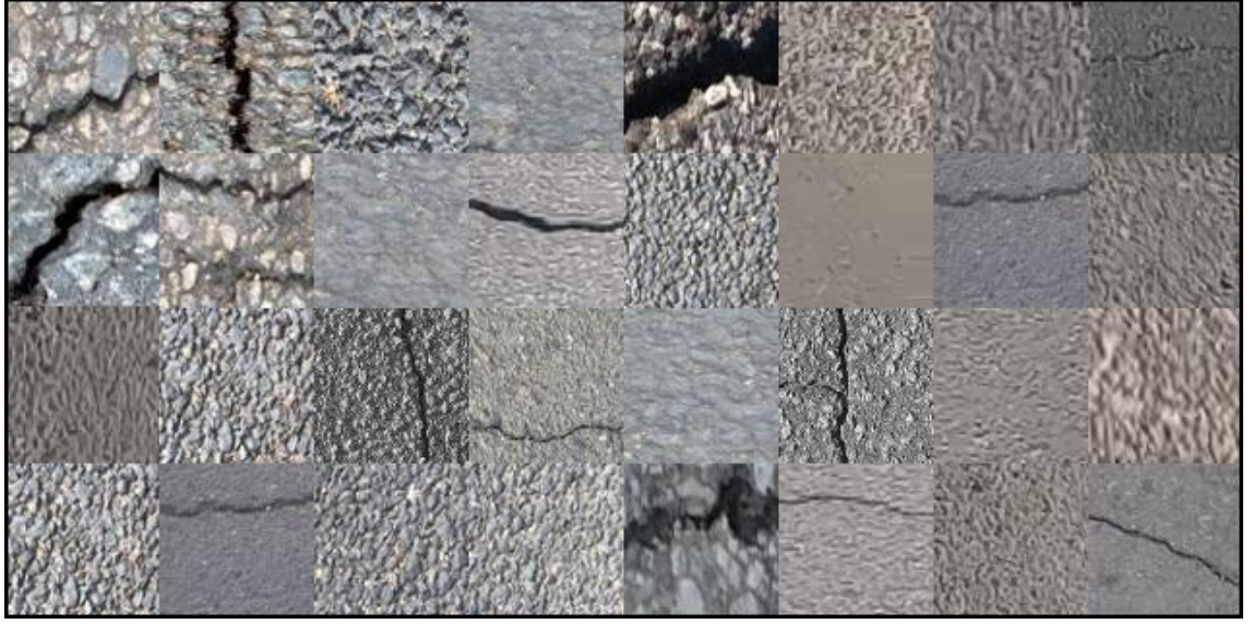
Şekil 3.12. Rastgele olarak alınmış çatlak içeren ve içermeyen 80x80 piksel boyutunda görseller
