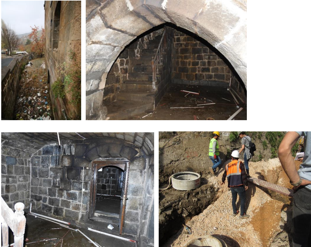
Şekil 3.49. Geleneksel Bitlis Evlerinde drenaj sorunlarından kaynaklı yapıların durumu
