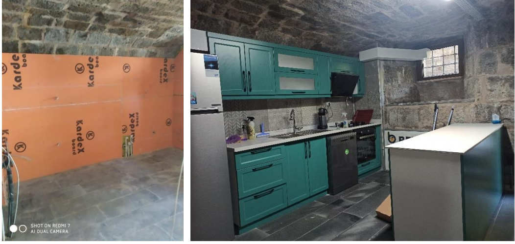
Şekil 4.53. Mutfak mekânında sonradan eklenen duvar imalatı
