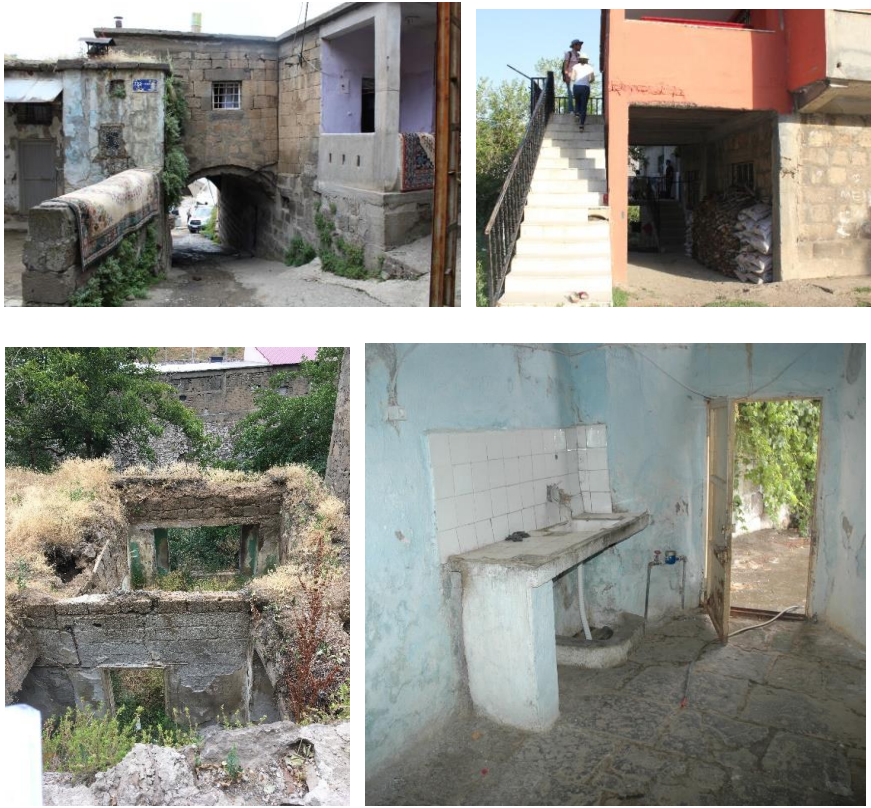
Şekil 3.50. Geleneksel Bitlis Evlerinde eklentilerden dolayı yapılarda oluşan bozulmalar (BÇ arşivinden alınmıştır)
