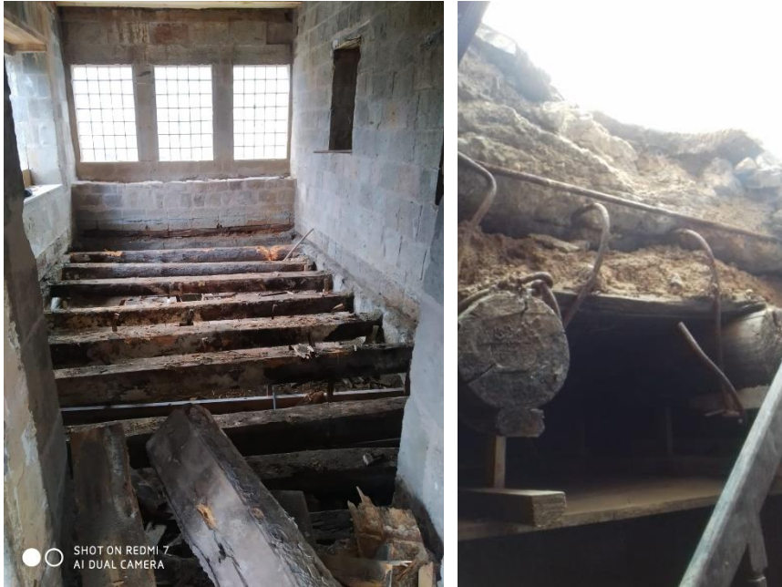
Şekil 4.54. Birinci kat döşemesinin yükten dolayı zayıflayıp kısmen çökmesi
