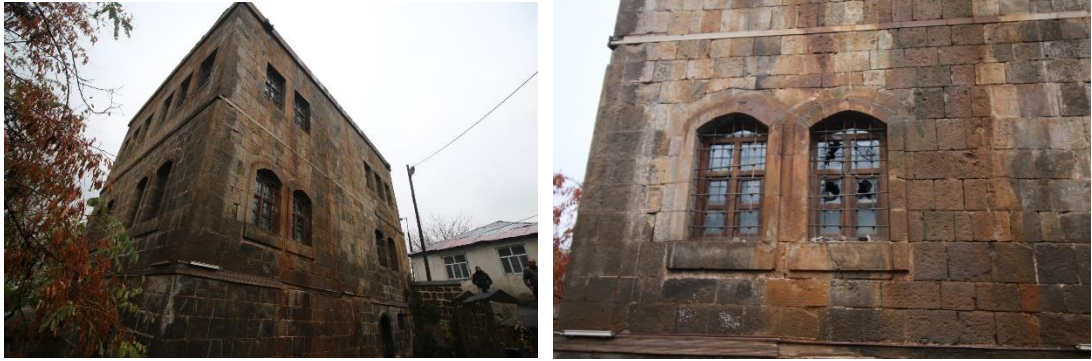
Şekil 4.18. Restorasyon öncesi su alan dış duvarlar (Çapras, 2020)
