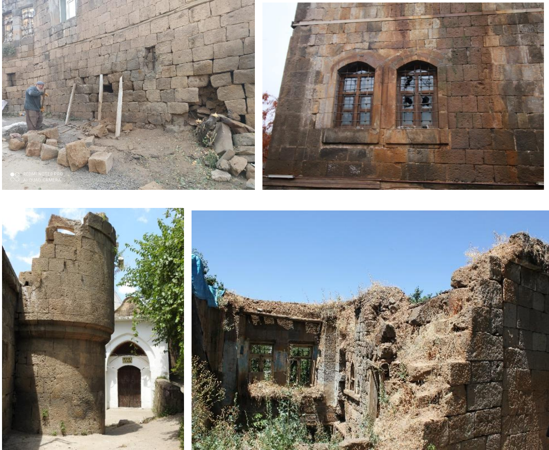
Şekil 3.48. Geleneksel Bitlis Evlerinde mevcut duvar hasarları (BÇ arşivinden alınmıştır)
