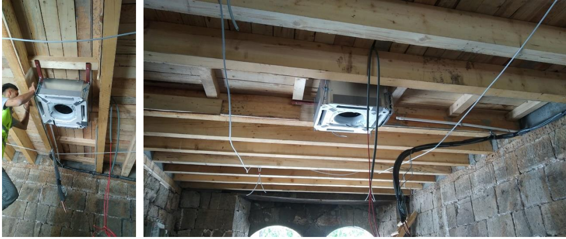
Şekil 4.65. Klima bağlantı kanalları
