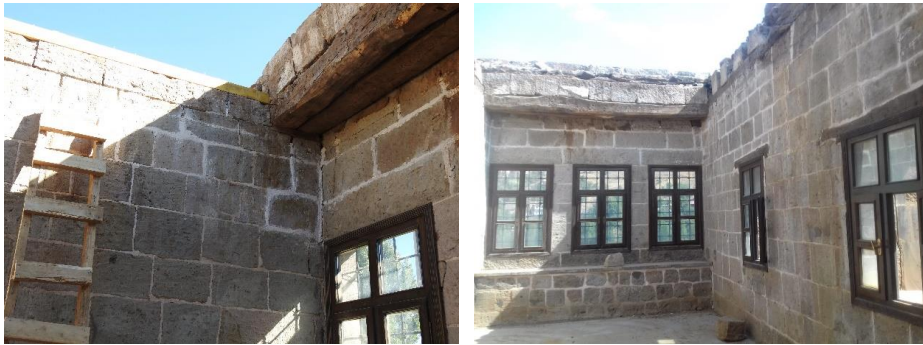
Şekil 4.13. Birinci kat doğu cephesinde duvar çatlaması
