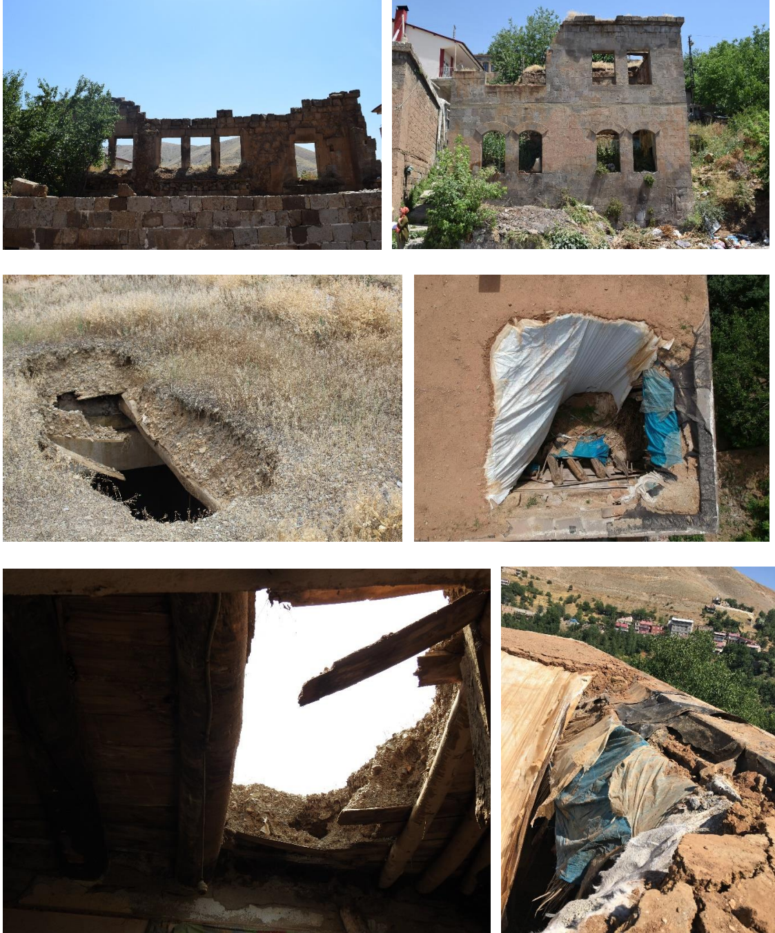
Şekil 3.47. Mevcut dam hasarları (BÇ arşivinden alınmıştır)
