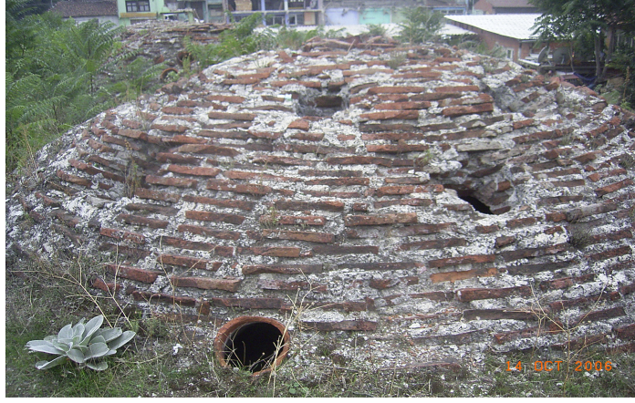
Şekil 3.10 Sıcaklık kubbesinde yer alan filgözleri
