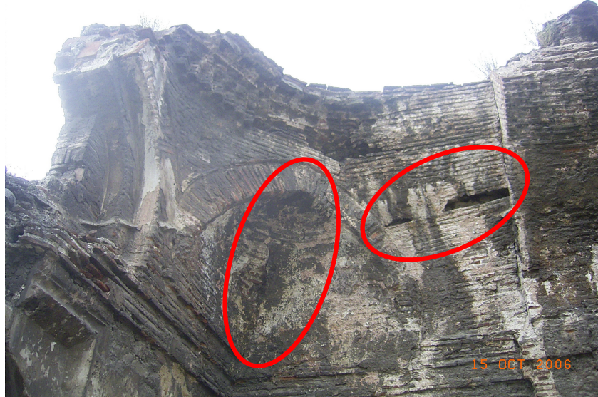
Şekil 3.27 Erkekler soğukluk bölümünde tromp köşe bölgesinde ve kemer tromp arasında oluşan malzeme kayıpları
