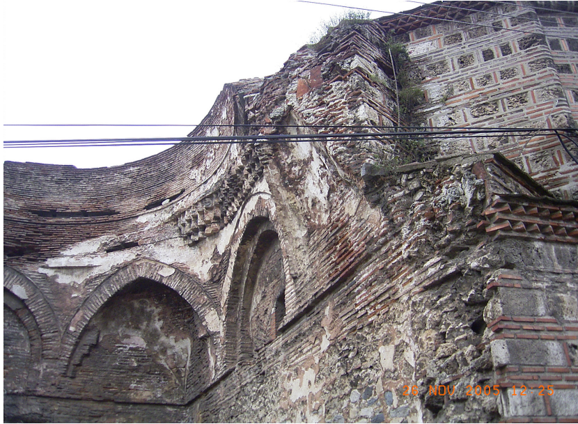
řekil 3.16 Soyunmalık kuzey duvarında bulunan atlaklar
