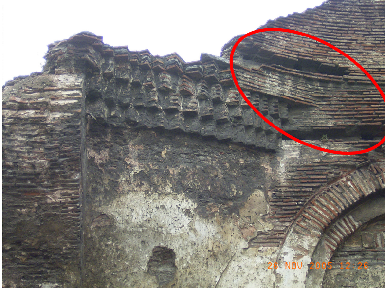
Şekil 3.25 Erkekler soğukluk bölümünde oluşan malzeme eksilmeleri
