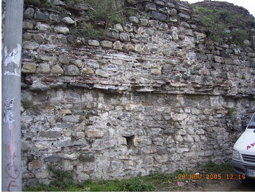
Şekil 3.18 Erkekler güney cephesinde boşalan ahşap hatıl boşlukları
