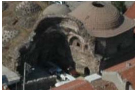
Şekil 3.189 Yapının erkekler soğukluk bölümünün mevcut halde yıkık olan bölgeleri
