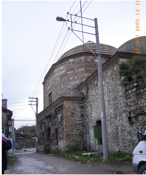
Şekil 3.8 Hamamın kuzey cephesinde dökülen kesme taşlar
