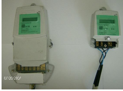
Şekil 2.18. Trifaze ve monofaze elektrik sayaçları
