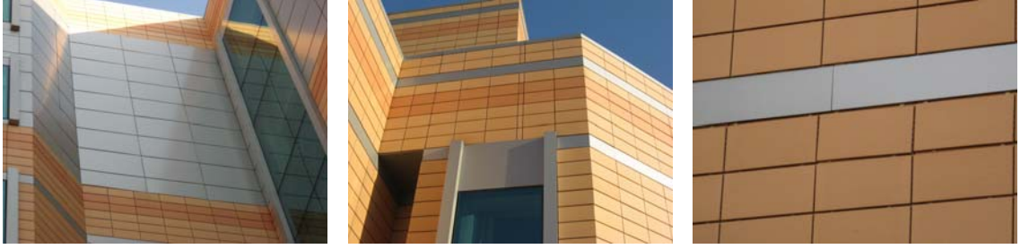
Şekil: 3.11; Tuğla panellerin yanlış boyutlandırılması “Acıbadem Hastanesi, Nilüfer, Bursa”, (Tair, G. 2009).
