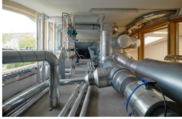
Şekil 3.31. Heidenau Anaokulu mekanik sistem uygulaması (Anonim 2021o)
