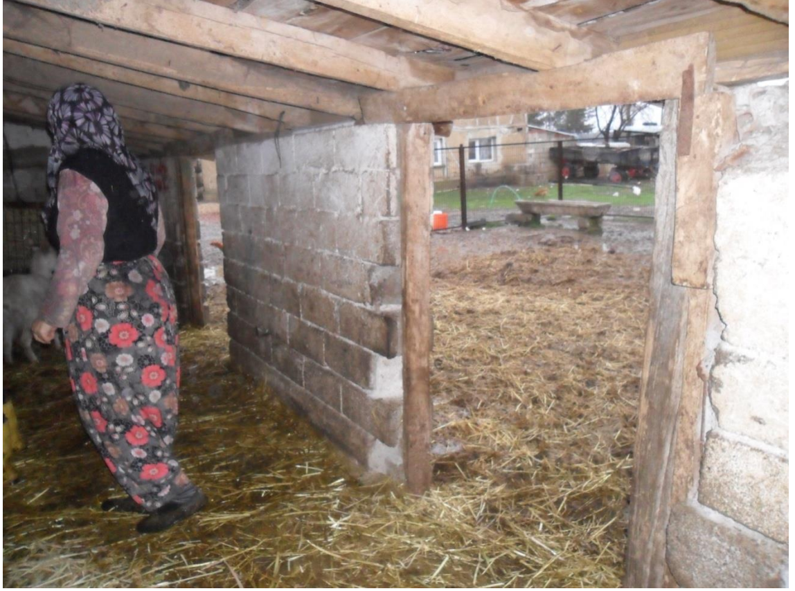
Şekil 4.5. Yan duvar yüksekliğinin yetersiz olduğu bir işletme
