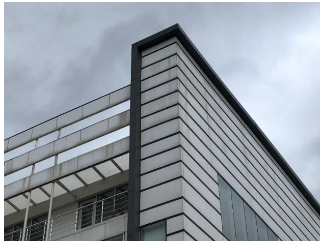
Şekil 4.65 Tezeller İş Merkezi - Yüzey Kirlenmesi
