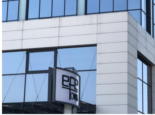
Şekil 4.16. Efe Towers- Yüzey Kirlenmesi
