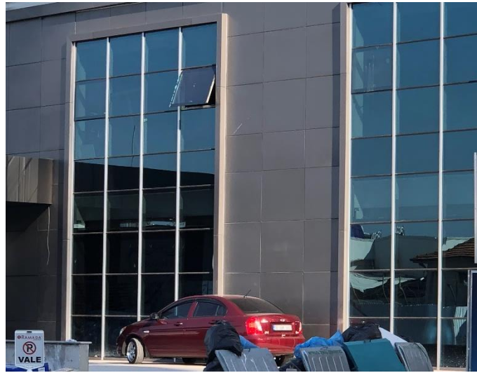
Şekil 4.27 Zorlu-Çelebi Plaza- Yüzey Kirlenmesi ve Lekelenmesi
