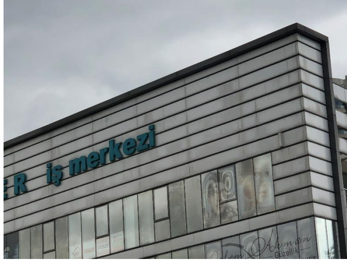
Şekil 4.64 Tezeller İş Merkezi - Yüzey Kirlenmesi
