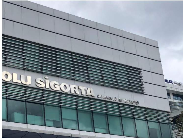
Şekil 4.50 Zeno Center - Yüzey Kirlenmesi
