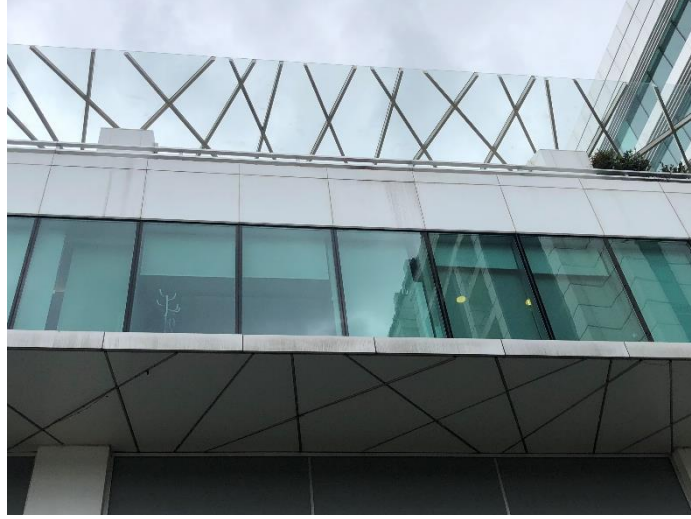
Şekil 4.49 Zeno Center - Yüzey Kirlenmesi
