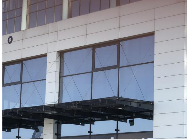
Şekil 4.17. Efe Towers- Yüzey Kirlenmesi
