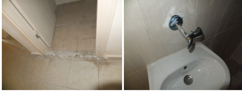
Şekil 5. 70-Şekil 5. 71. Uygulamada yapım kalitesini düşüren işçilik sorunları
