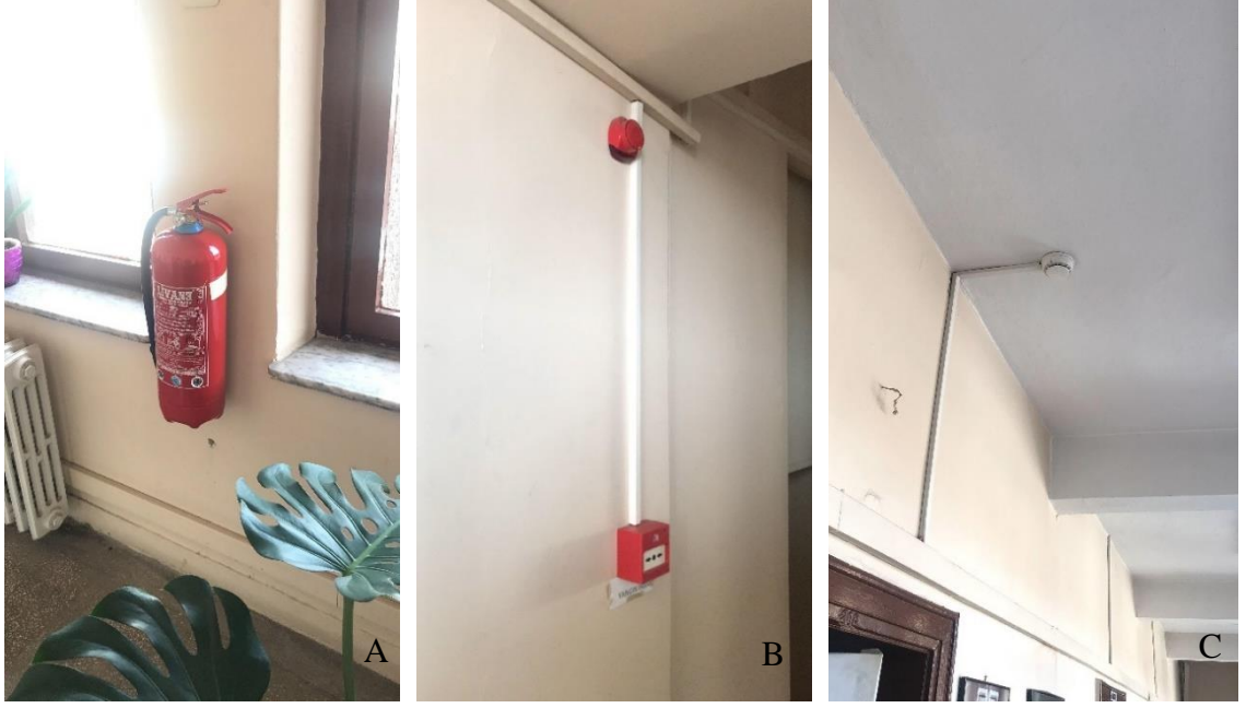
Şekil 4.12. Yapıda kullanılan yangın söndürme ve yangın algılama sistemleri A) Taşınabilir söndürme cihazı B) Yangın uyarı butonu C) Duman dedektörü
