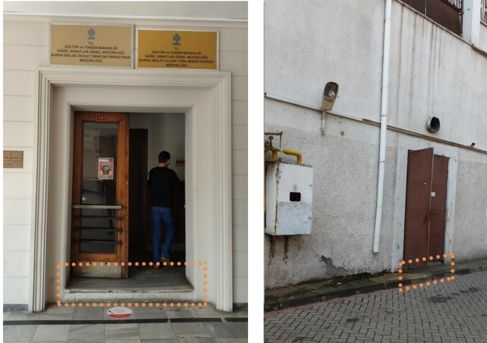
Şekil 4.6. Dışarı çıkış kapılarında BYKHY'ye aykırı olarak eşik bulunması A) Ön cephe giriş kapısı B) 2. Bodrum kat çıkış kapısı
