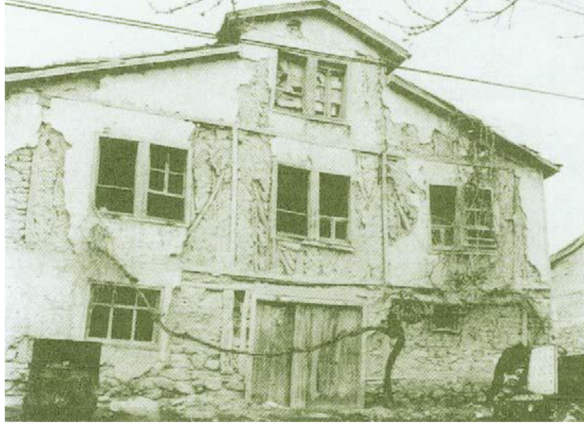
Şekil 7.1. Deprem sırasında sıva ve boyası yer yer çatlamış ve dökülmüş bina örneği (2002 Sultandağı) (Doğangün ve ark. 2006)
