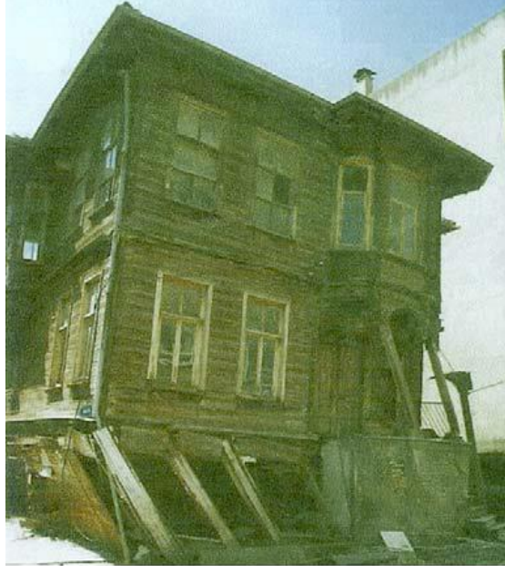
Şekil 7.3. Zayıf kat nedeniyle depremde hasar görmüş yapı örneği (Bayülke 2004)
