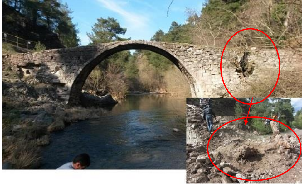
Şekil 3.125. Cüneyt köprüsünün (15. yy.) ayağında her iki cephede de görülen ağaç. Tempan duvar sökülüp, kök temizlenip, ilaçlanıp duvar yeniden örülmüştür
