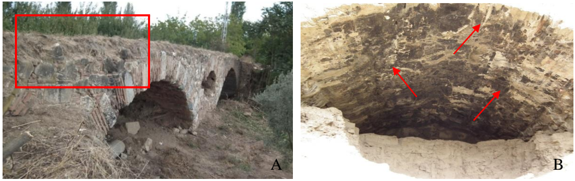
Şekil 3.147. İnikli Köprüsü a) Zamanla yitirilen döşeme kaplaması sebebiyle tempan duvar taşlarındaki dağılmalar b) Tonzlarda oluşan nem ve tuz çıkışları
