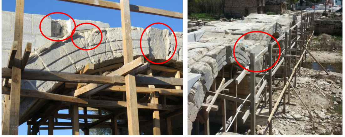
Şekil 3.126. Tarihi Aizonai Köprüsünde taşlarda aşınma ve parça kaybı
