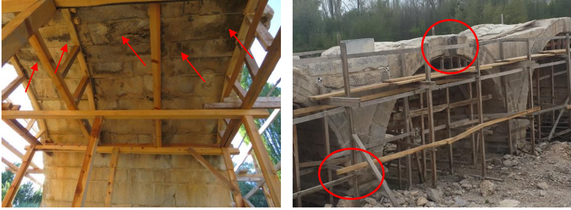
Şekil 3.135 Tarihi Aizonai Köprüsünde tempanda ve tonoz içlerinde taş yüzeylerinde görülen kirlenme sorunu
