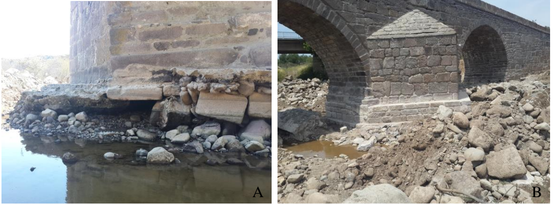
Şekil 3.115. Behramkale Köprüsü a) A4 ayağı temelindeki malzeme kaybı ve oyulma b) Bu ayakta yapılan ampırtman
