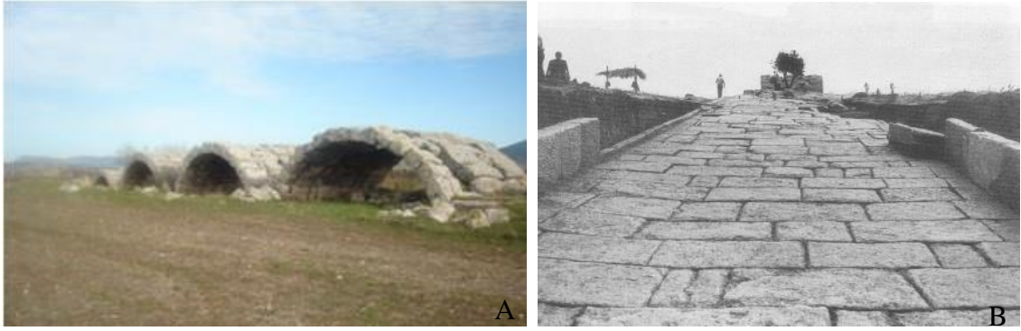
Şekil 3.51. Tarihi Gülpınar (Roma) Köprüsü, Çanakkale a) Köprü görseli b) Köprü'nün döşemesi ile devamındaki tarihi yol (Özgünel 2013)
