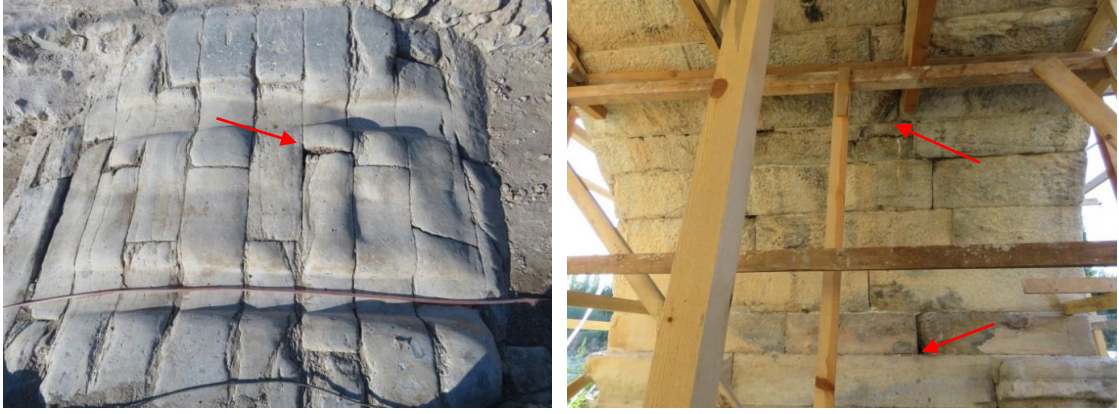
Şekil 3.134. Tarihi Aizonai Köprüsünde kemer sırtlarında ve tonoz içlerinde görülen derz boşalmaları
