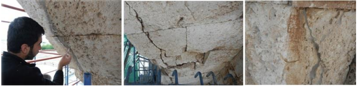
Şekil 3.123. Malabadi köprüsündeki çatlak konservasyonu (Sert ve ark. 2016)
