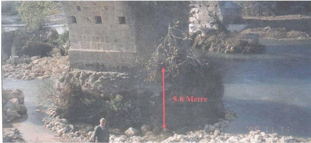
Şekil 3.110. Aspendos Köprüsünün nehir zemin seviyesinin düşürülmesi sebebiyle temelleri açığa çıkmıştır (Sert ve ark. 2009)
