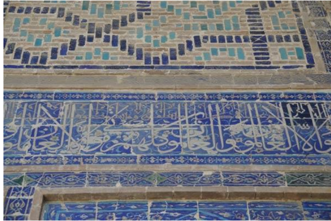
Şekil 3.9. Uluğ Bey Medresesi'nde dış duvar üzerindeki süslemeler: tuğla desenler ve yazılar (Anonim 2019d)
