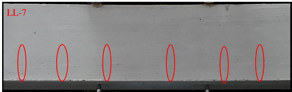
Şekil 4.96. LL-7 kirişinde oluşan ilk çatlaklar
