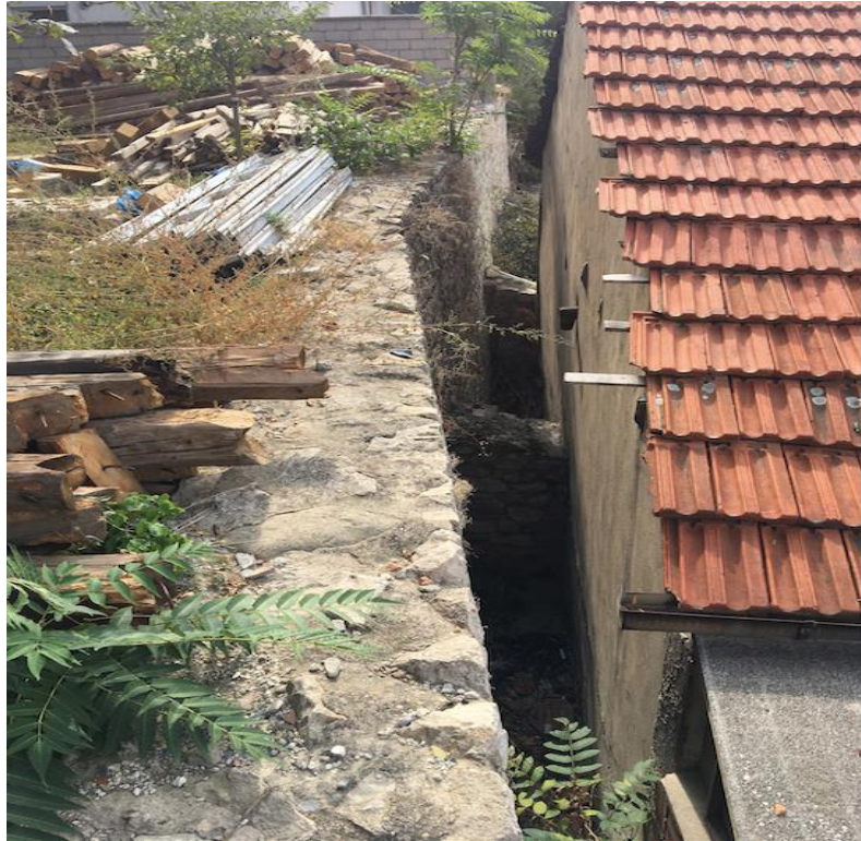
Fotoğraf 32: Sultan Murad Camii batı avlu duvarı
