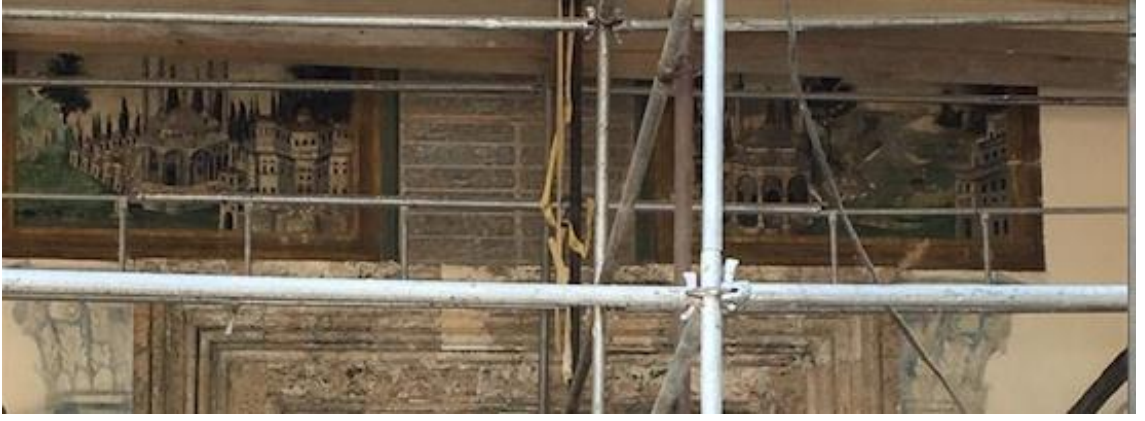
Fotoğraf 41: Sultan Murad Camii cümle kapısı üzerindeki manzara tasvirleri (Restorasyon süreci devam ederken. Eylül 2019)
