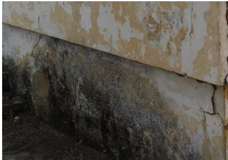
Şekil 4.17 Duvarda yosun oluşumu
