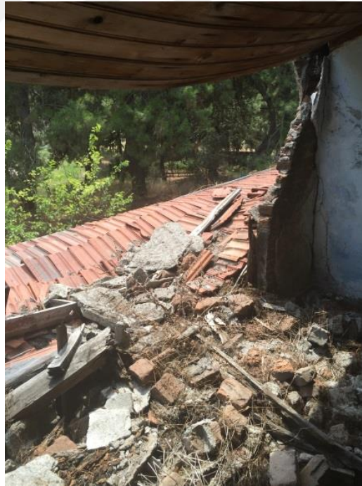
Şekil 4.31 102 nolu oda duvarında kopma
