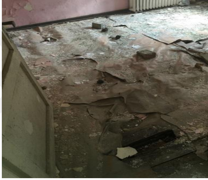
Şekil 4.35 Döşeme kaplamasında, eksilme ve çatlaklar
