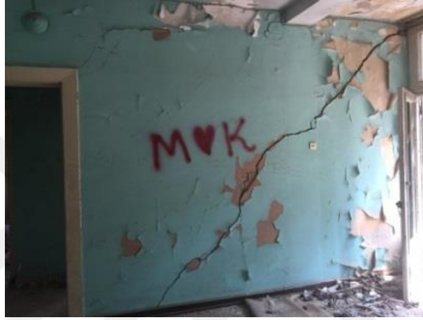
Şekil 4.34 Vazife Evi'nin iç mekan duvarında oluşan kayma çatlak
