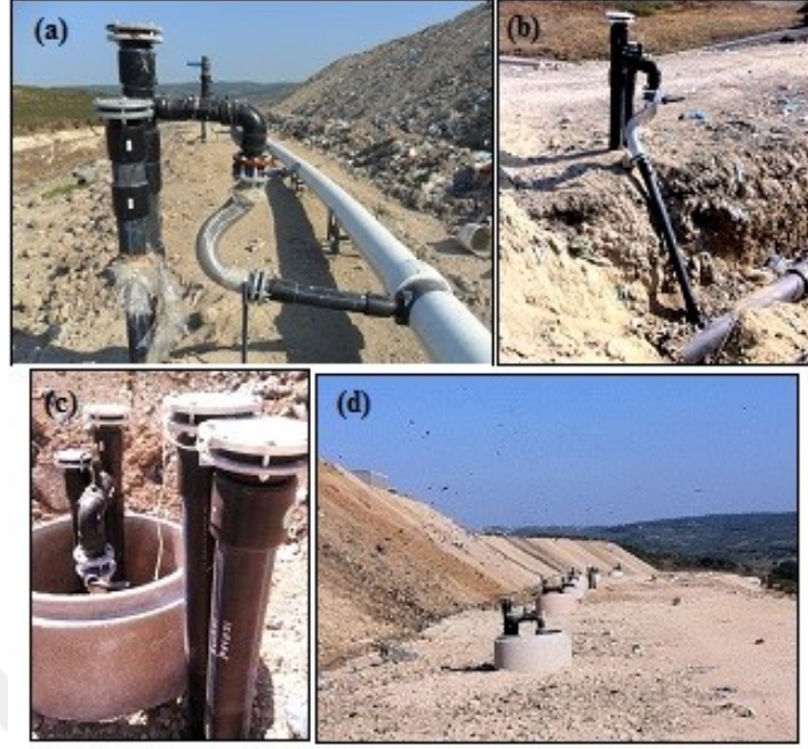
Şekil 4. 15. Hamitler Enerji Üretim Tesisi gaz toplama sistemi için (a) ve (b) saha içi gaz toplama hattının ana toplama hattına bağlantıları (c) ve (d) zemin üstü bağlantı koruma bilezikleri
