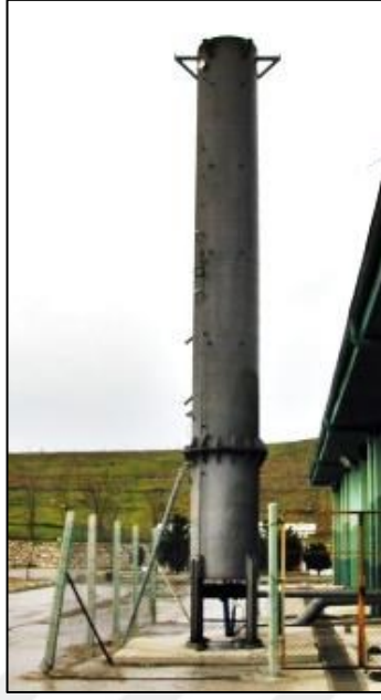
Şekil 4. 28. Demirtaş Enerji Üretim tesisi jeneratör grubu gaz yakma bacası
