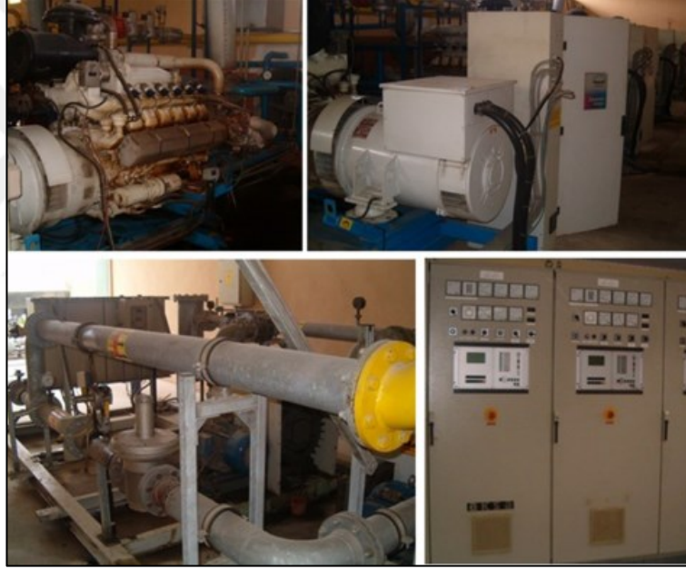
Şekil 4. 27. Demirtaş Enerji Üretim tesisi jeneratör grubu
