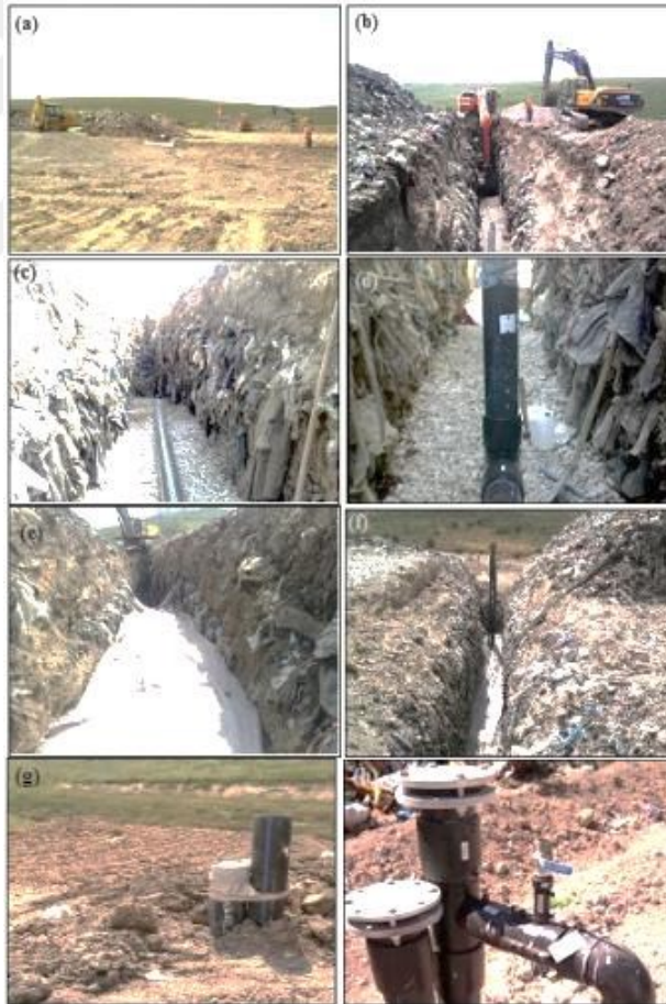
Şekil 4. 13. Hamitler Enerji Üretim Tesisi gaz toplama sistemi için (a) hatların yerlerinin belirlenmesi (b) hatların açılması (c) çakıl yatak (d) yatay ve düşey bağlantılar (e) jeotekstil malzeme (f) dolgu malzemesi olarak atık kütlesi (g) ve (h) gaz ve sızıntı suyu toplama bağlantıları
