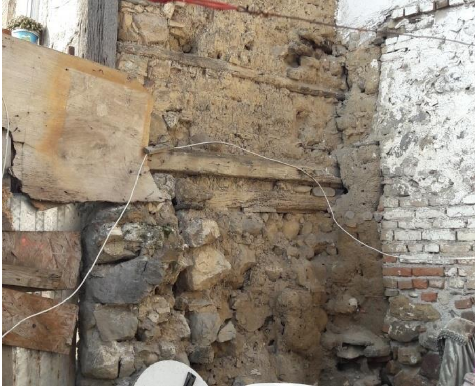
Şekil 4.4. Cepheye bitişik yıkılmış istinat duvarı
