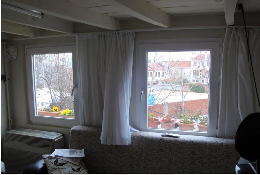
Şekil 3.12. Z07 Oda’da bulunan pvc pencereler
