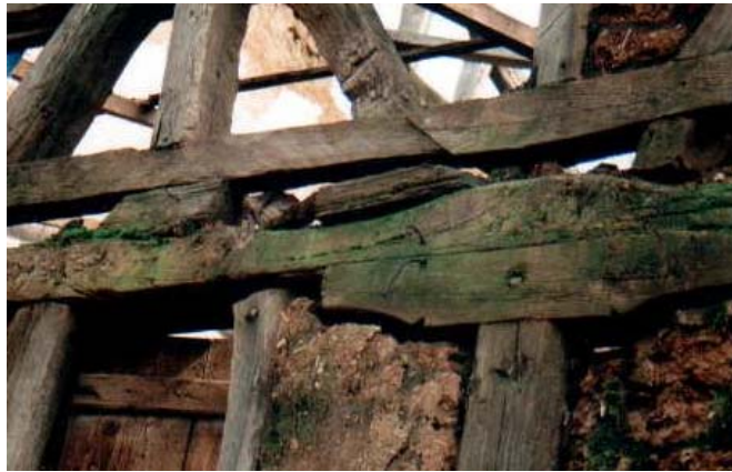
Resim 8. Cumalıkızık Konutlarının Ahşap Yapı Elemanlarında Bakteri ve Mantar Etkisi
