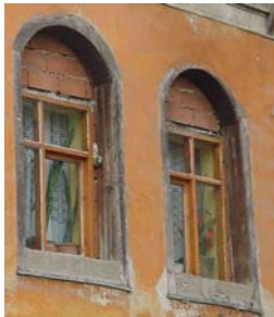
Resim 10. Cumalıkızık Geleneksel Konutlarında Hatalı Onarım Etkisi
