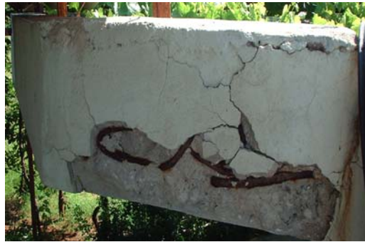
Şekil 2: Korozyona uğramış donatı (Şimşek 2005)
