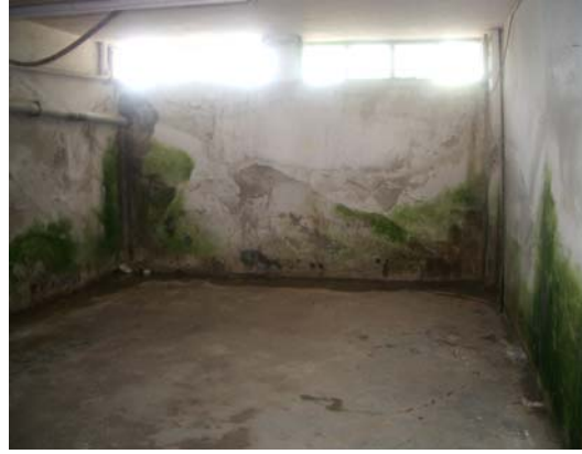
Şekil 1: Zemin suyunun bodrum kat betonarme perde duvarlarında oluşturduğu hasarlar (Şimşek 2005)
