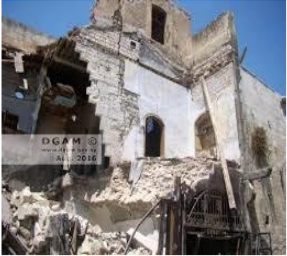
Şekil 52. Gazali Evi'ndeki hasar (Anonim 2016f)
