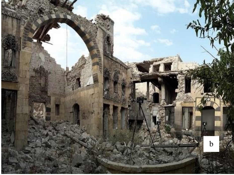
Şekil 61. Açıkbash Evi'nde yaşanan hasar (Anonim 2016f)
