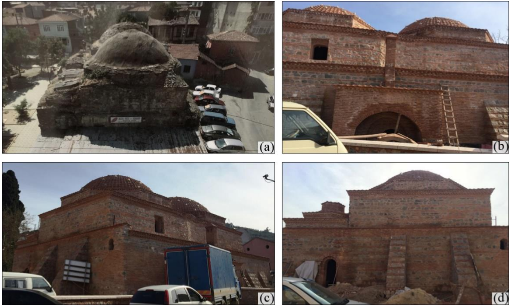
Şekil 3. 71. (a) Restorasyon öncesi (Hasan Bey Hamamı Arşivi) (2016), Hasan Bey Hamamı Restorasyon çalışmaları (b) kuzeybatı cephesi, (c) doğu cephesi (d) güneydoğu cephesi (2016)
