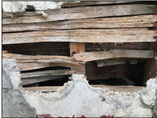
Şekil 3.34. Ahşap malzeme de görülen bozulma (Göktaş 2019 arşivi)
