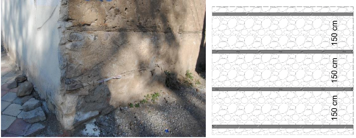
Şekil 3.16. Ahşap hatıl a) İnceleme alanındaki örnek duvar b) Hatıl şematik gösterim (Göktaş 2019 arşivi)
