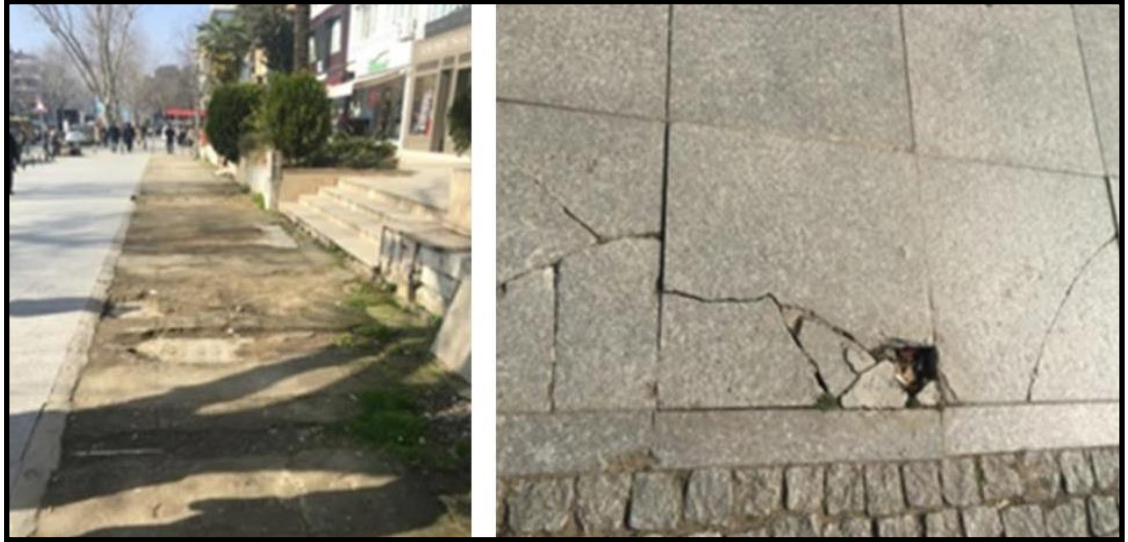
Şekil 4.49. Bağdat Caddesi'nde tespit edilen hasarlı zemin kaplamaları (Pınar ÖZKAN, 2019- Orijinal)
