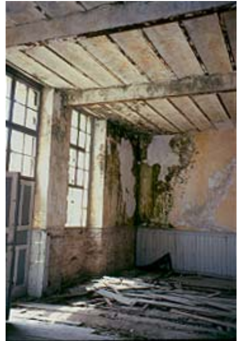
Resim 7: Yapı Döşemelerindeki Bozulmalar
