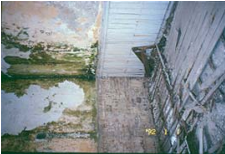
Resim 6: Yapı İç Duvarlarındaki Bozulmalar
