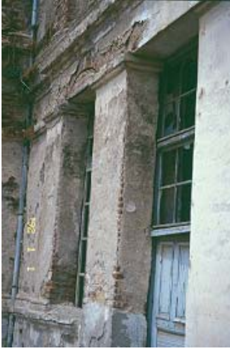
Resim 4: Yapı Duvarlarında Dış Bozulmalar
