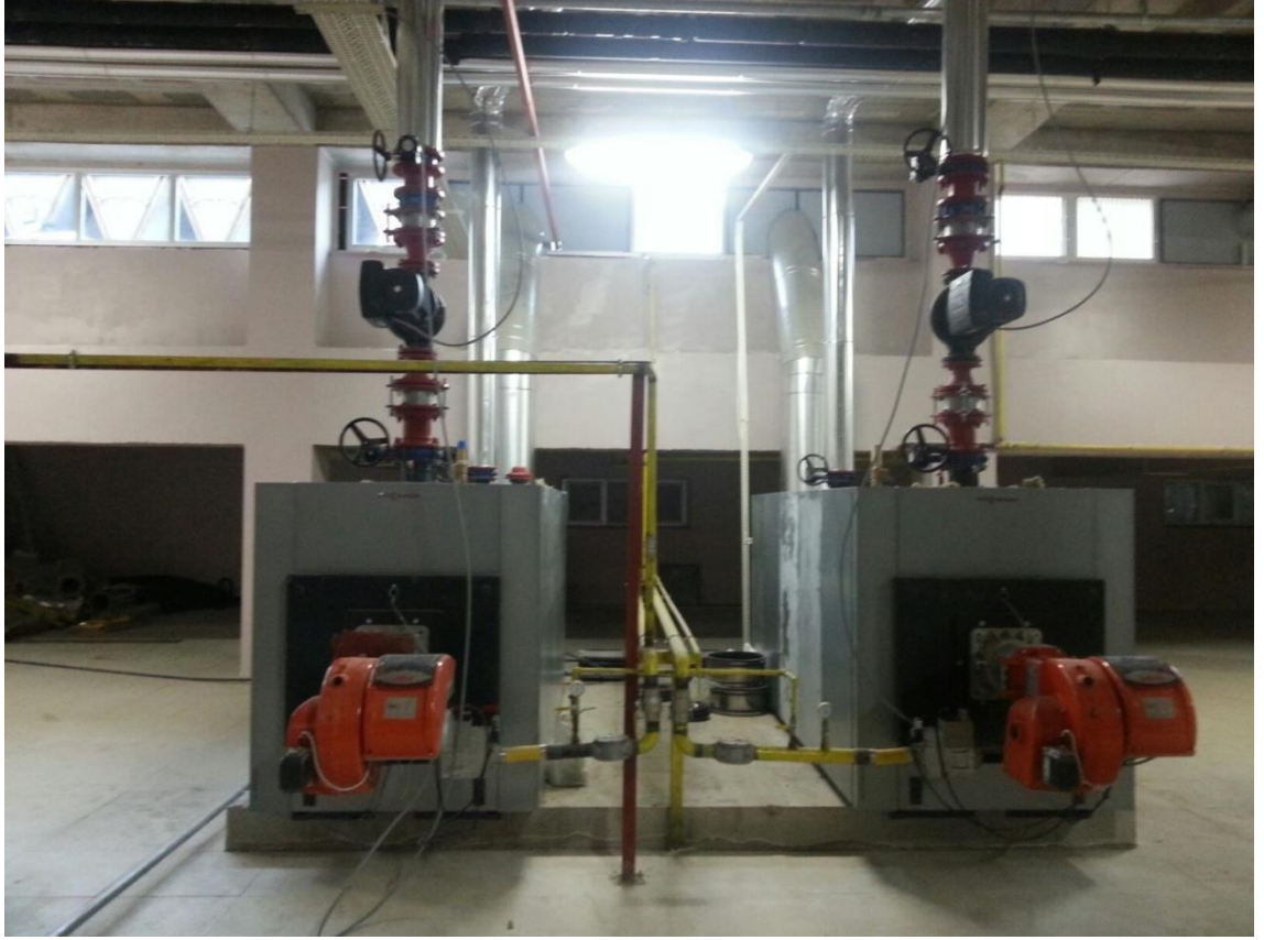
Şekil 4.3. Teknik hacimde bulunan kazanlar.
