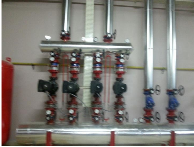
Şekil 4.4. Isıtma kollektörü ve pompalar.
