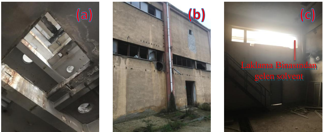
Şekil 3.51. Lak kulesi-2018(a), laklama binası-2018(b), solvent geri kazanım bölümü-2018(c)
