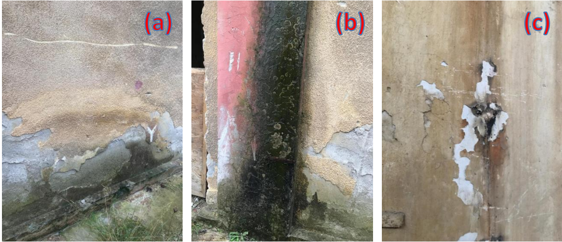
Şekil 4.17. Yapıda oluşan yosunlaşma-2018(a), yapıdaki sıva dökülmeleri ve yosunlaşma-2018(b), yapıdaki boya dökülmeleri-2018(c)
