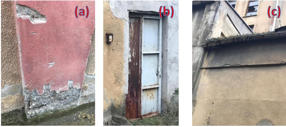
Şekil 4.18. Cephede sıva ve boya dökülmesi-2018(a), kapılarda korozyon-2018(b), çatıda bitkilenme-2018(c)
