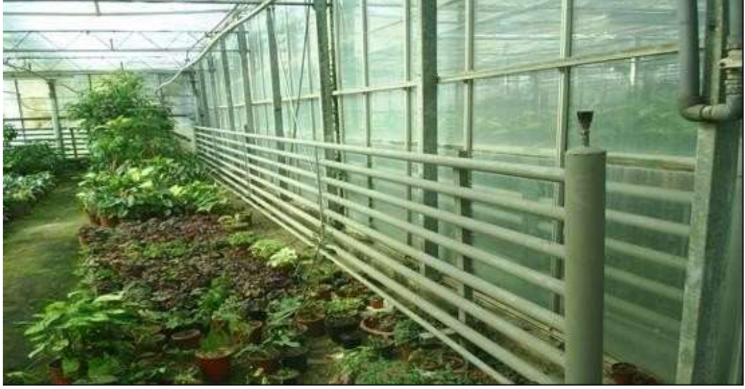
Şekil 4.10. Kaloriferli ısıtma sistemlerinde sera yan duvarlarına yerleştirilen ısıtma boruları
