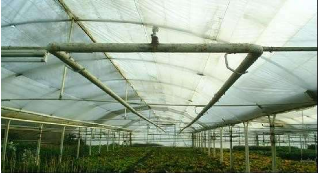
Şekil 4.9. Kaloriferli ısıtma sistemlerinde sera tavanına yerleştirilen ısıtma boruları
