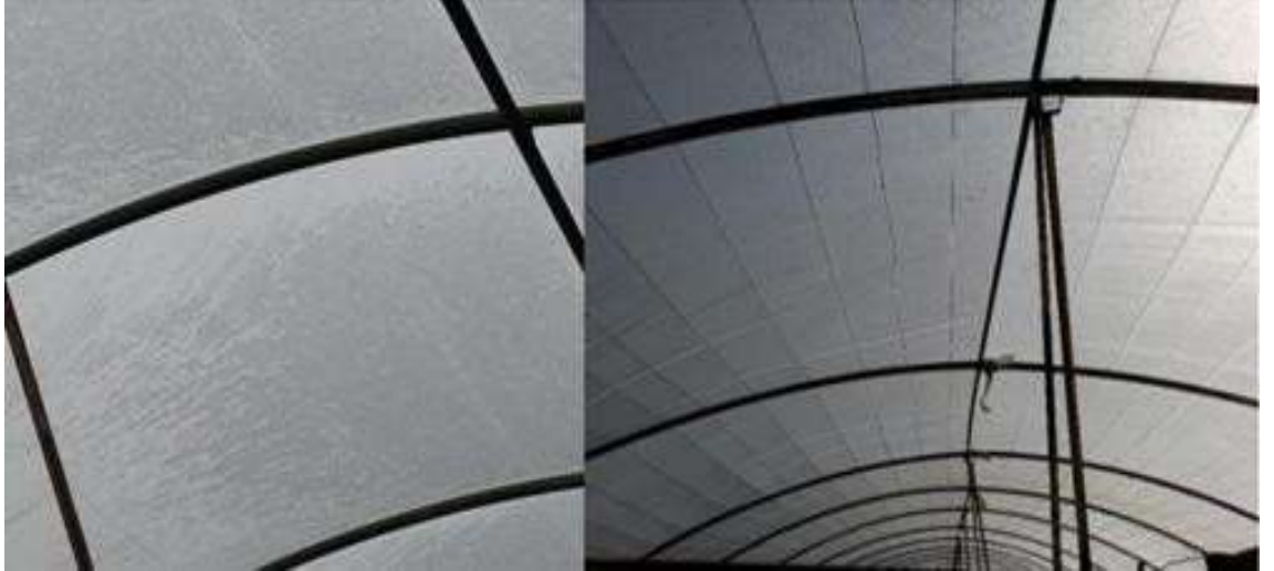
Şekil 2.7. Uygun olmayan havalandırma koşullarında sera örtü malzemesinde oluşan nem yoğunlaşması
