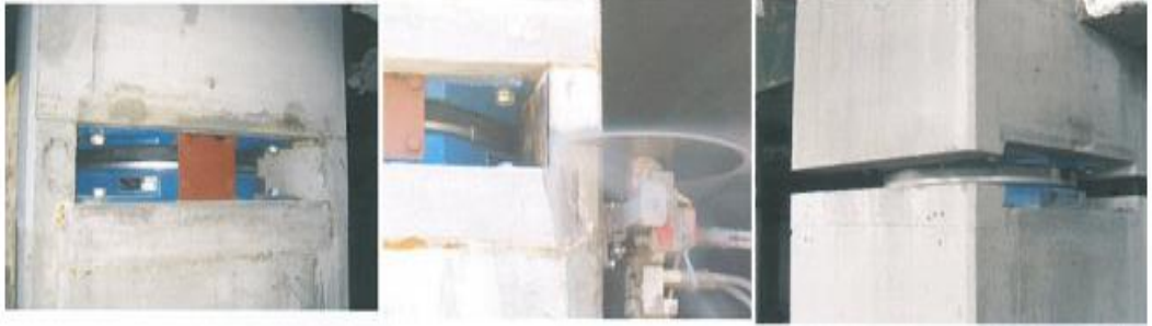
Şekil 2.29 İzolatörlerin kolonlara monte edilmiş hali (Kök 2014)
