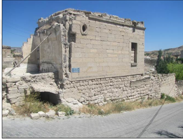
Şekil 3.57. Üst kotta yıkılmış olan oda
