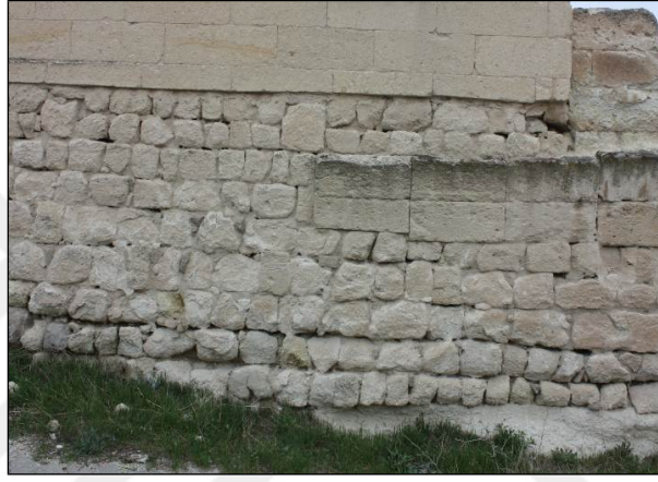
Şekil 3.64. Toprak kotuna yakın yerlerde su ve nemden kaynaklı derz boşalmaları
