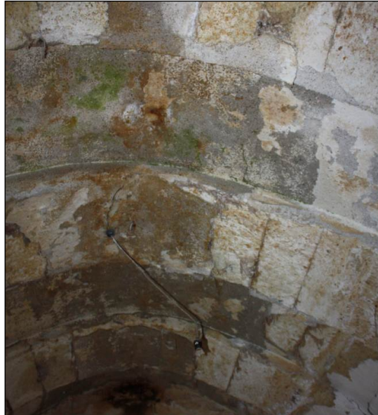
Şekil 3.63. Çatıdan su alan 102 No'lu odanın tonozunda görülen nem problemleri
