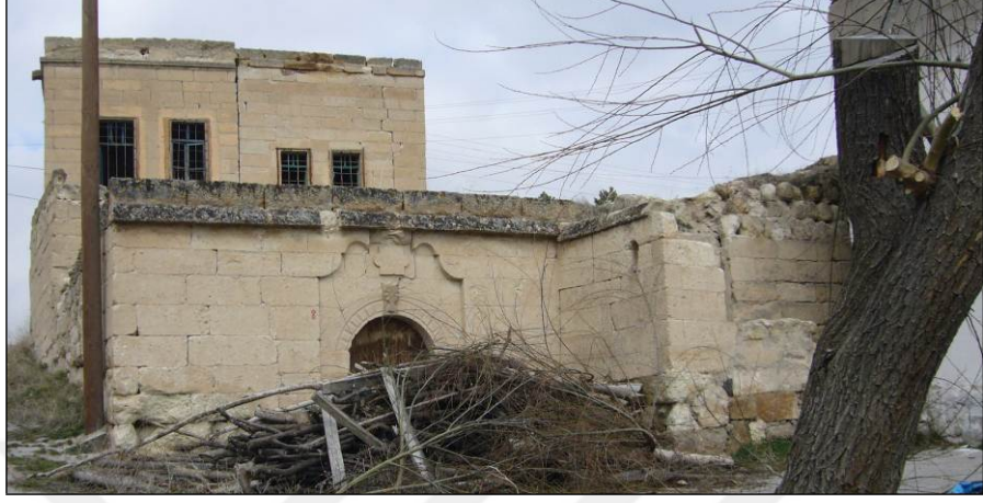
Şekil 4.18. Güney cephede giriş kapısının doğu yönünde bulunan helanın fotoğrafı
