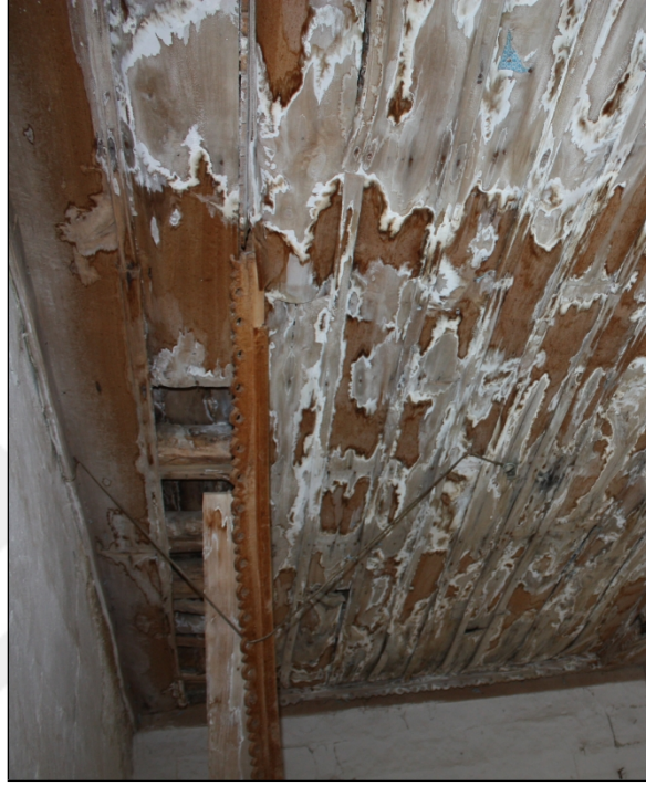
Şekil 3.62. 101 No'lu odanın çatıdan su alması nedeniyle ahşap tavanda oluşan çürüme
